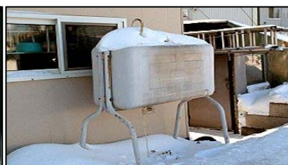
オイルタンク
